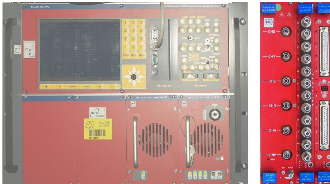
Abbildung 3.8.: Hochspannungsrahmen CAEN SY1527 mit den Hochspannungsnetzteilen für Kathoden (CAEN A1526N), Anoden (CAEN A1821P) und SiPMs (CAEN A1510) (v.l.n.r.)
