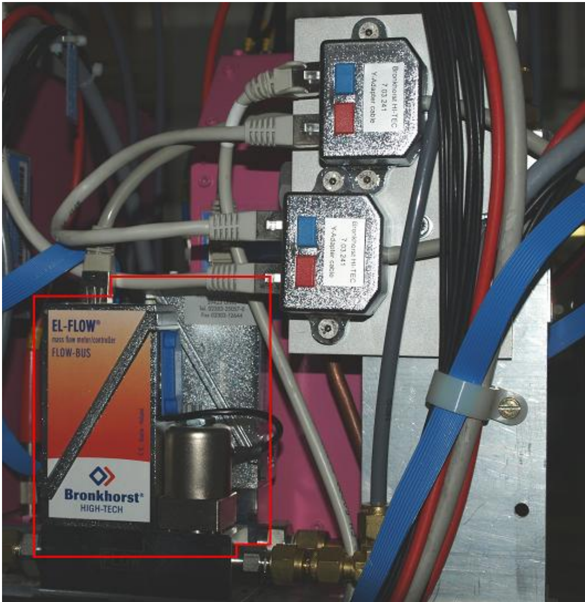
Abbildung 3.13.: Druck- und Flussregler an einer Kammer. Der Fluss wird am Eingang, der Druck am Ausgang der Kammern geregelt. Steuerung und Auslese der zwölf Regler erfolgt über einen Datenbus, dessen Kabel und Adapter oberhalb der Regler zu sehen sind.
